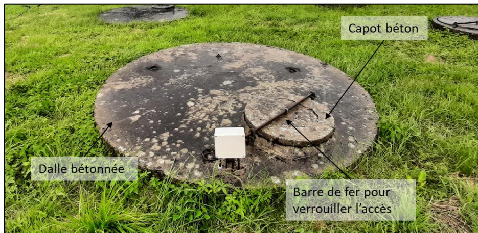
Figure 15 : Tête du puits 2
